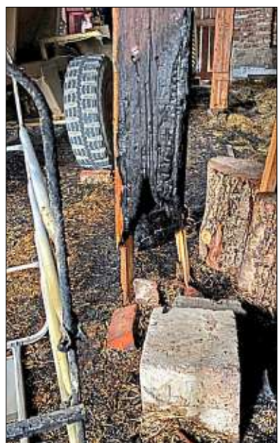
Die Holzsäulen in der Scheune wurden von unten angekokelt.
