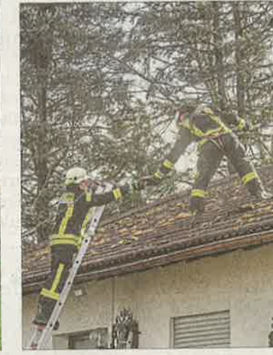
Dachdecken wurde im Bereich
