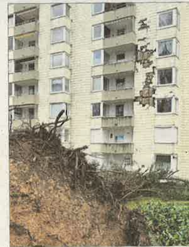
Fassade zerstört, Baum entwur-
